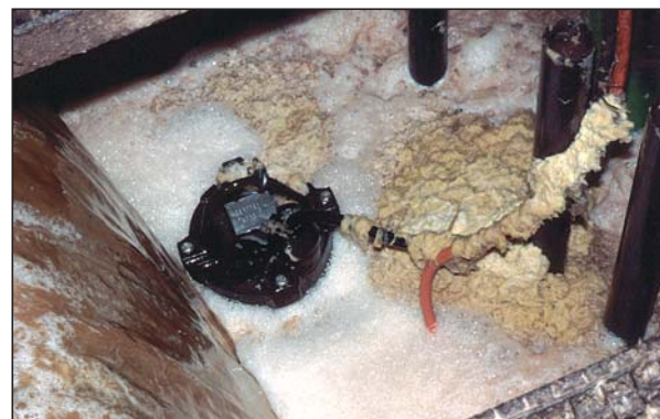
Фото 2: Один из двух насосов Grundfos из нержавеющей стали используется на предприятии, изготавливающем стекловату, для отведения технологических стоков с высоким содержанием абразивных частиц. Оба насоса оснащены эффективной системой промывки торцевых уплотнений вала.
